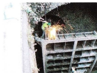
Découpe des axes de la porte aval du petit sas (1 ère écluse)
