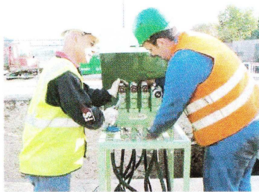
Patrick Picquenard de l'Atelier du Service des canaux et Nicolas Janvier de l'entreprise Hydriflex devant une unité de distribution hydraulique
